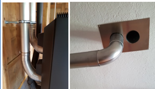
Bei der Installation wurde Rücksicht auf das unter Heimatschutz stehende Gebäude genommen. Die alten Holzwände und Decken wurden nach Möglichkeit von Holzdurchbrüchen verschont und die Warmluft über einen EI 90 - Luftkanal im Estrich und der Decke geführt.
