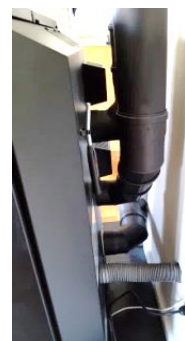
Warmluftabgänge ab Ofen für die Austritte im EG/OG zur Beheizung der Räume.
