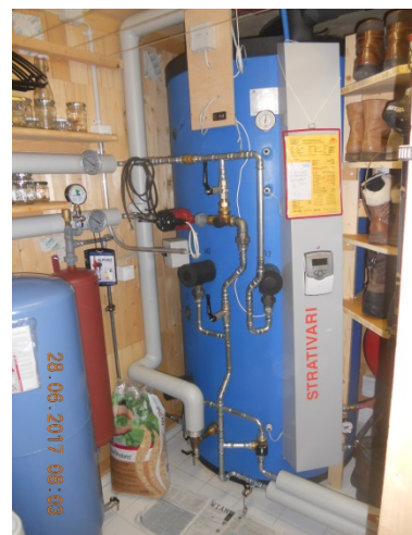
Kombi-Wärmespeicher (1000 Ltr) für Raum- und Brauchwasser.
